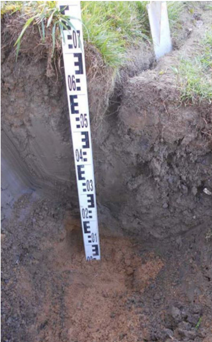
Abbildung 7: Schurf im Deich mit Rissbildung
