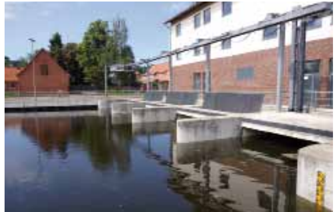
Schöpfwerk in Hitzacker
